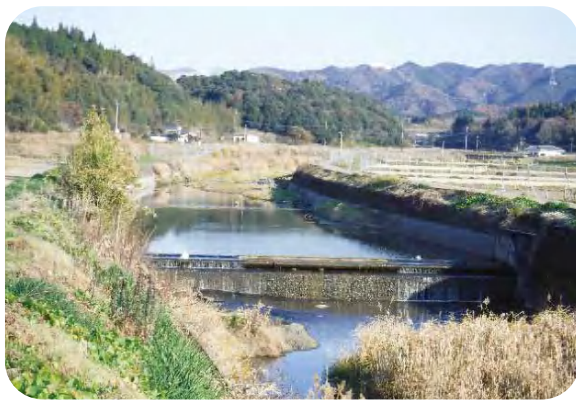
老朽化した頭首工
