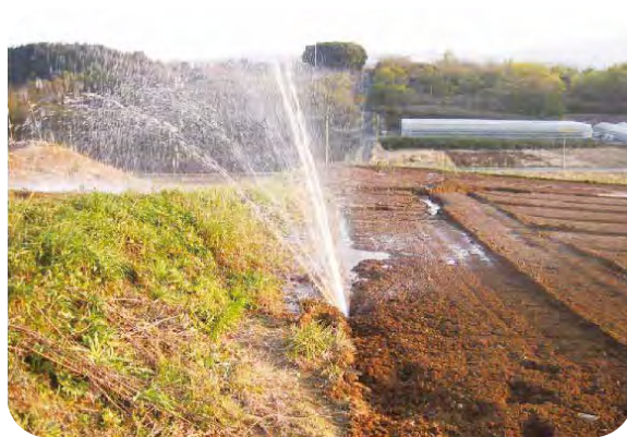
石場ダムパイプラインの漏水状況
